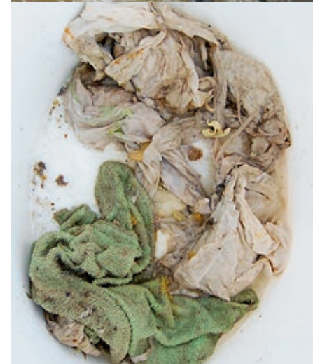
Angeschwemmter Abfall im Pumpwerk Oberwil
