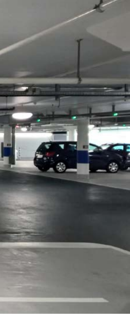
Sanierteres Parking mit LED-Leuchten – damit lässt sich viel Energie sparen.
