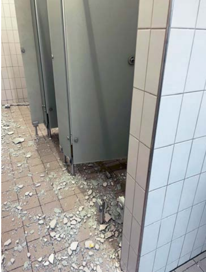
Vandalismus im WC
