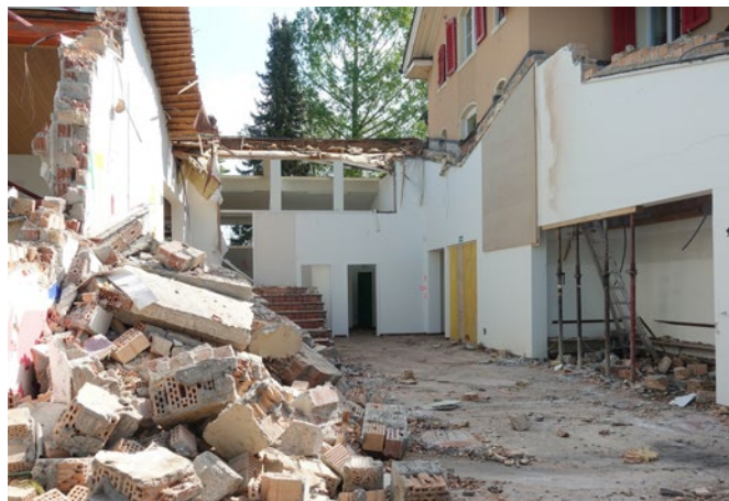
Beim Umbau wurde das Fresko geschützt, damit es auch künftig das Schulhaus zieren kann. (siehe rechte Seite Mauer).
