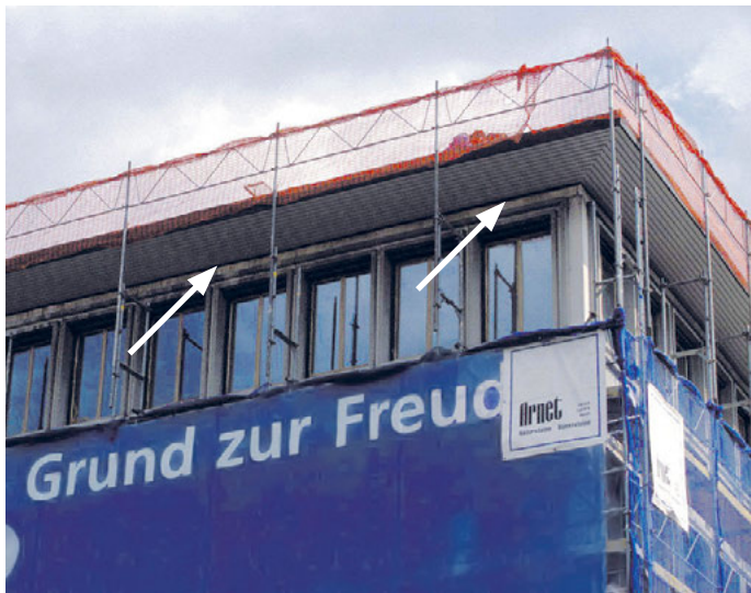
Baugerüst, durchlässig für die Alpensegler. Die Arbeiten an der Dachuntersicht wurden rechtzeitig beendet.
