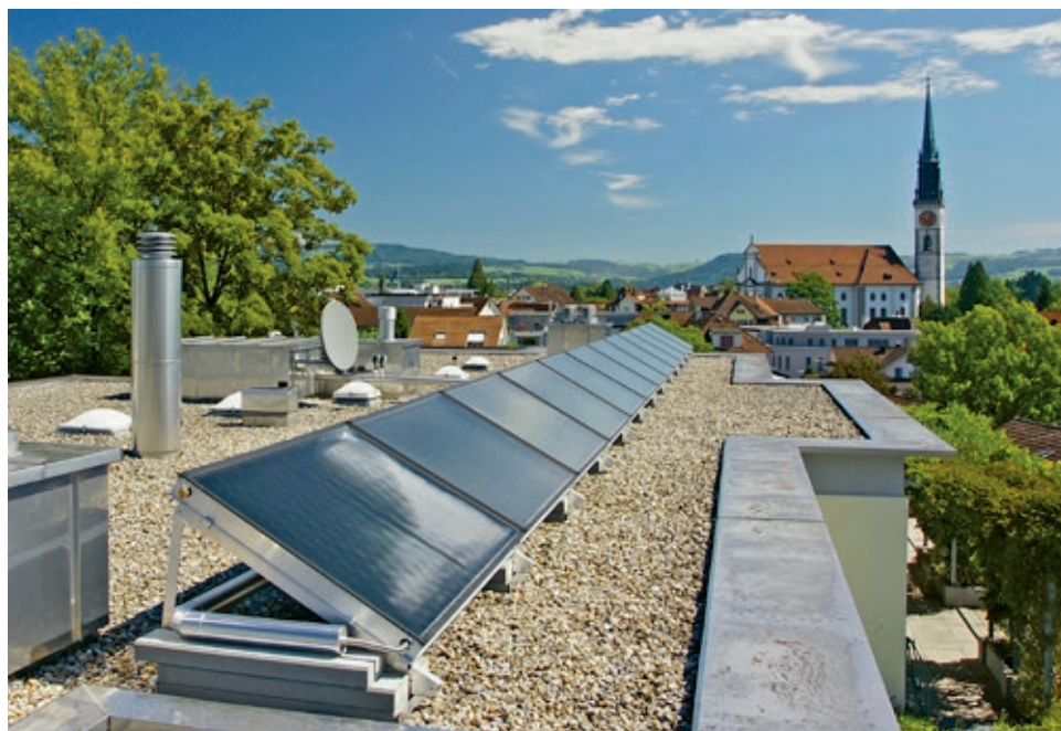
Cham unterstützt die Nutzung erneuerbarer Energien mit Förderbeiträgen. Foto: Furrer Solartechnik
